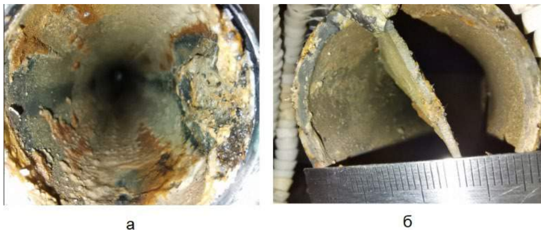
Рис. 2. Загрязнения в трубном пространстве экспериментальных моделей: а – без ленточного завихрителя; б – с ленточным завихрителем
